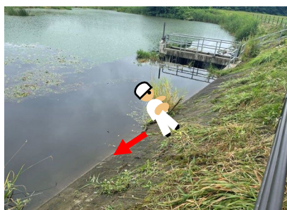
(ため池堤体の急傾斜)
